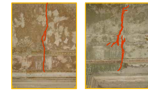
Particolari del tipo di lesione: lesioni passanti, stanze a e b.
